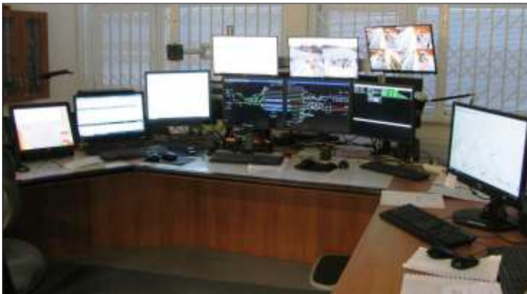
Staré elektrodynamicke zabezpečovací zařízení bylo nahrazeno moderním jednotným obslužným pracovištěm – JOP. Pohled do zrekonstruované dopravní kanceláře. Pracoviště výpravčího ve Veselí nad Moravou před předáním obsluhy na CDP Přešov.
