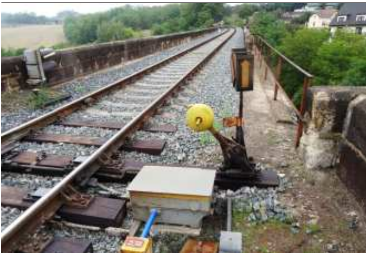
Ovládání výhybek i návěstidel je nyní na elektromechanické radiče. „Polepšili jsme si,“ libuje si signalistka. „Drátovody vedly až k výhybce devět na mostě.“
