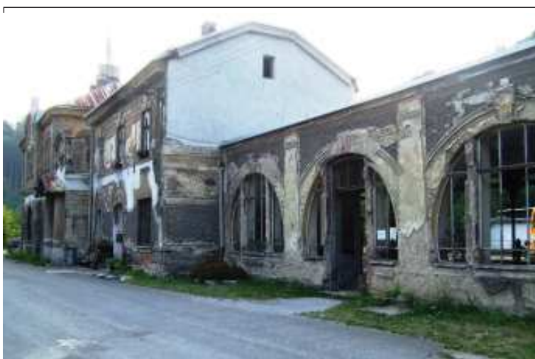
Zchátralost budovy vynikne zejména při pohledu z příchodové strany.
