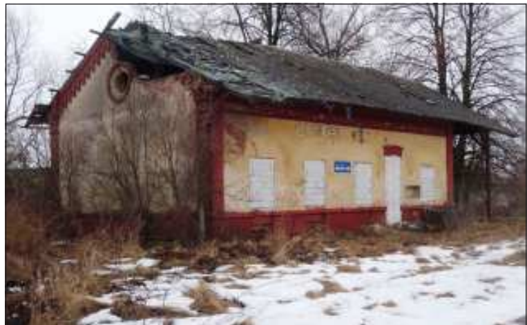
Objekt zastávky je sice vůči vandalům zabezpečný, ale střechou do budovy zatéká.
