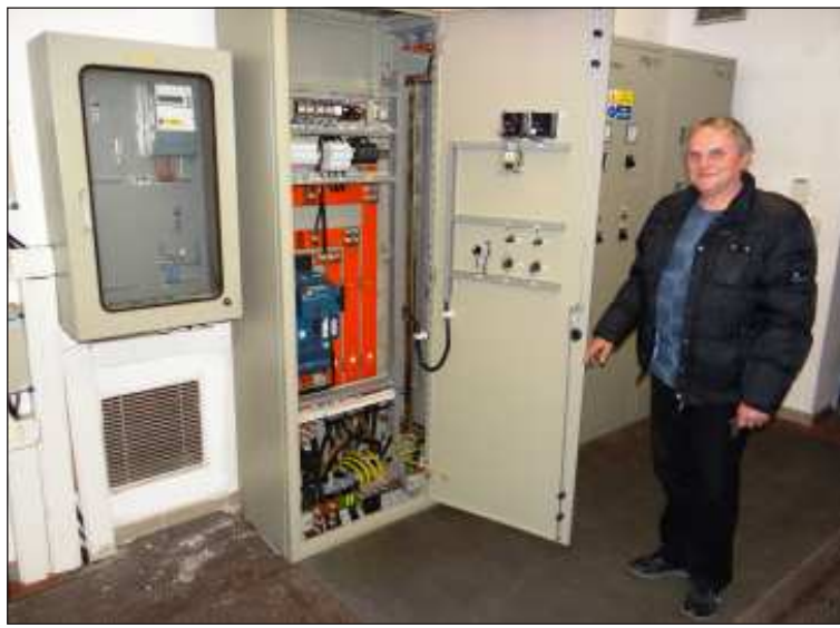
Vrchní mistr Rostislav Vavříček před jednou z rozvodných skříní.
